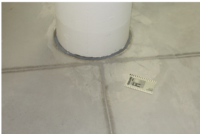
Abb. 15: Verfärbung des zementgebundenen Belages aufgrund falschem Fugenmaterial, ungünstige Fugensituation und unterschiedliche Fugendicke bei Säule
