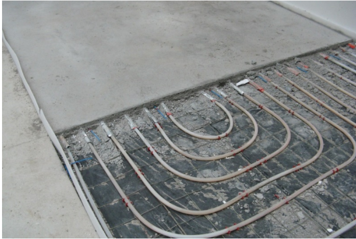
Abb. 6: Fußbodenbewegungsfuge bei Heizestrichen mit Überschubrohre und gleitfähiger Verdübelung – kreuzt entgegen der Normanforderung mehrmals die Bewegungsfuge.
