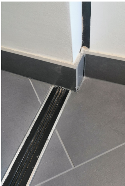
Abb. 11: Bauwerksfuge, beim Übergang von der Fußbodenfuge zur Wandfuge kommt es zur Ablösung des Sockels
