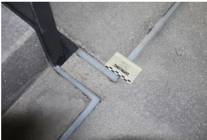
Abb. 13: Zu große Fugenbreiten zwischen Fertigteilstiegen und Ortbetonpodest
