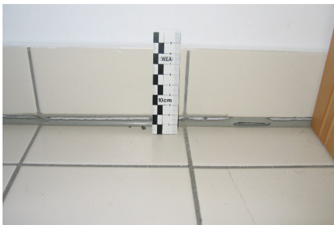
Abb. 14: Große Absenkung der Fußbodenkonstruktion führt zum Reißen der elastischen Verfugung zwischen Belag und Sockel
