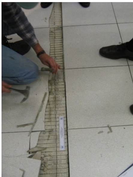
Abb. 9: Bruch der Fliesen entlang der Estrichschwindfugen, die nicht deckungsgleich in den Fliesenbelag übernommen bzw. nicht ausreichend kraftschlüssig verschlossen wurde
