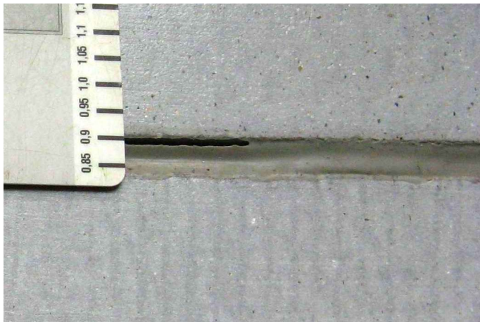
Abb. 16: Von der Fugenflanke gelöste Silikonverfugung
